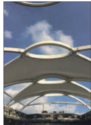
Dakconstructie van megawinkelcentrumcomplex Sambil Curaçao. Het dak is nu helemaal af en dicht.
