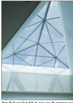
Een deel van het dak in een van de gangen van het winkelcentrum.
