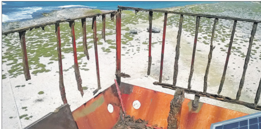
De bodem van het bordes van de vuurtoren is behoorlijk verroest. Werknemers die technisch onderhoud aan de vuurtoren doen, mogen van hun werkgever Imtech Marine Curaçao nv vanwege de onveilige situatie daar niet meer werken.
