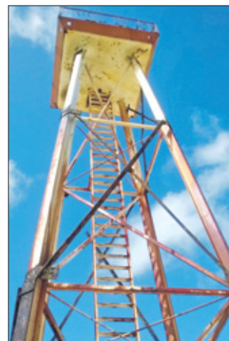
Werknemers kunnen zich door de slechte staat van de stalen constructie niet meer eraan vastketenen om het werk te doen. Sinds vorige maand wordt er geen technisch onderhoud meer aan de toren gedaan.
